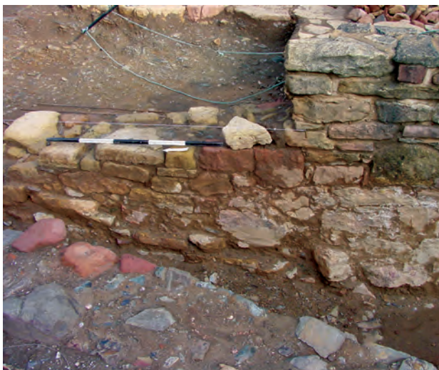
Fig. 7 - Extremidade norte da guarda oeste da ponte. Repare-se na identidade do aparelho da guarda e do paramento.
